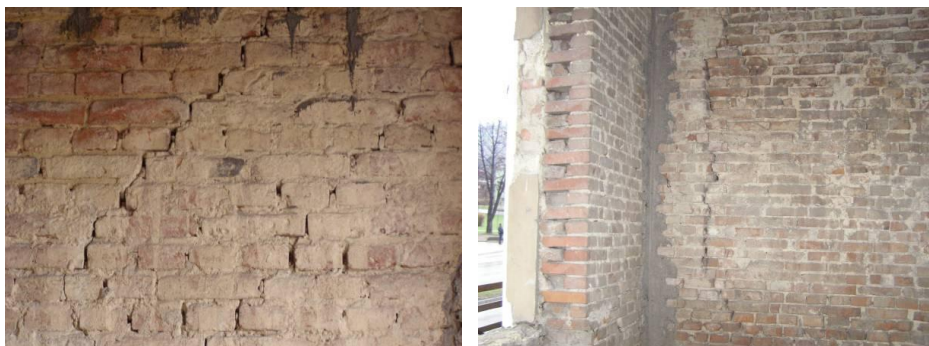
Slika 8. Pukotine u nosivim zidovima od opeke
